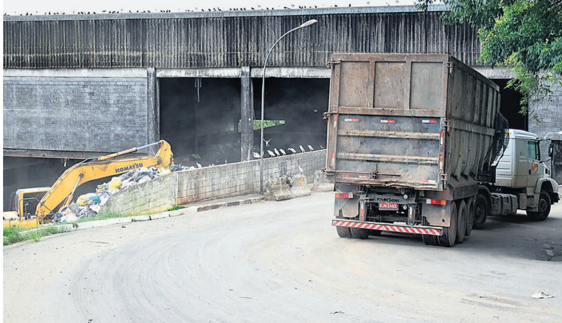
REUTILIZAÇÃO. Local vai transformar lixo orgânico em combustível para forno industrial ou geração de energia
