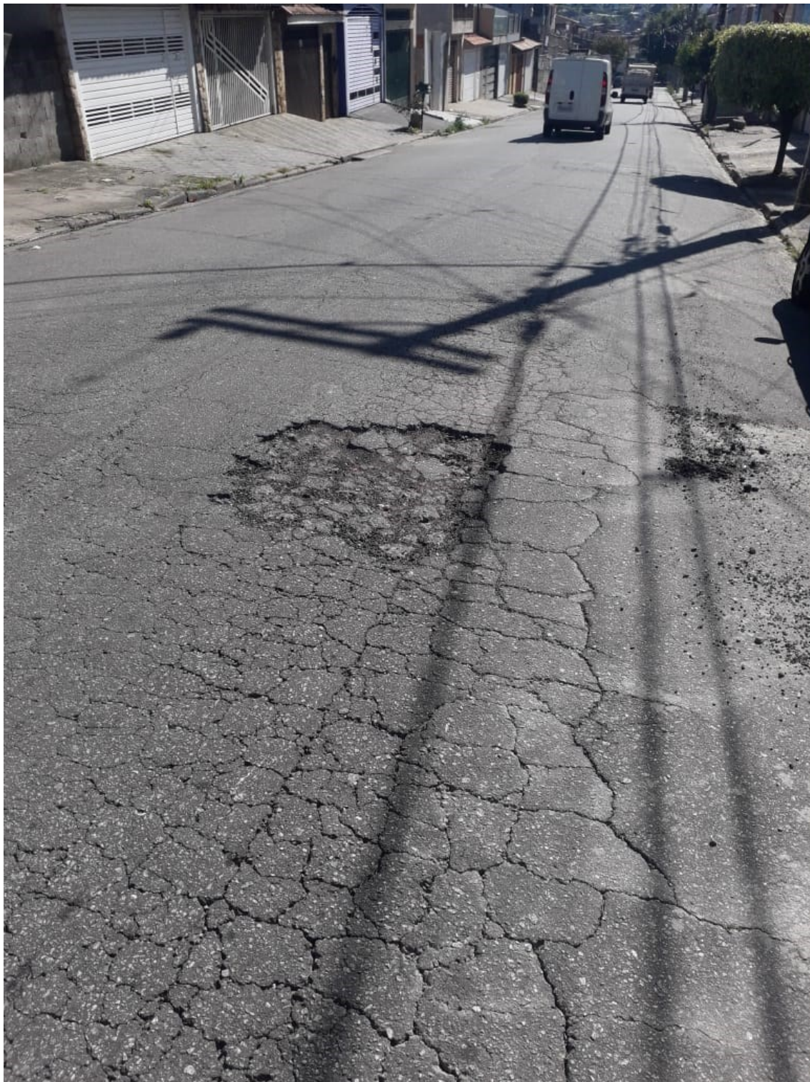
TAPA BURACO NA RUA EXP. OSCAR VANO
