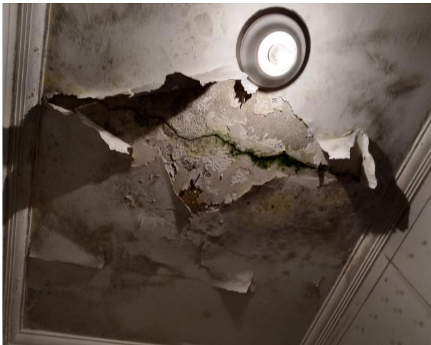
↑ TETO DO BANHEIRO, CAUSADO PELA ARVORE TOMBADA.
