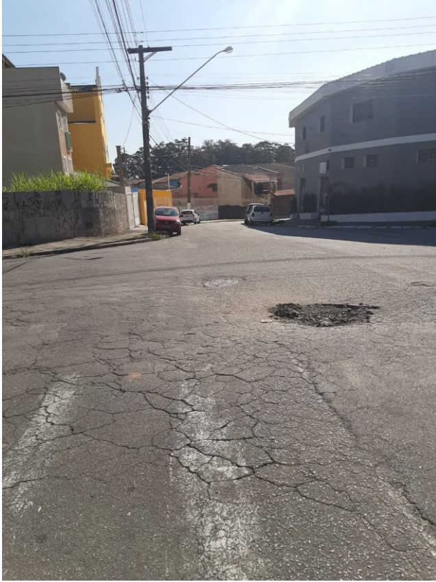
TAPA BURACO NA RUA EUCLIDES MENATO TRAVESSA COM RUA AGGEU SILVEIRA MONTEIRA – JARDIM MILENA.
