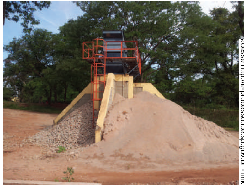
Usina de Beneficiamento de RCC.
