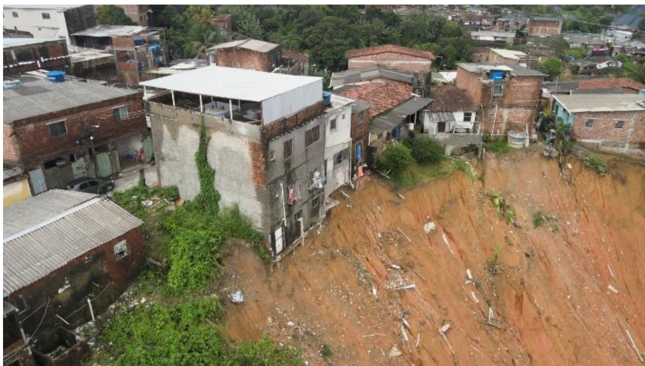
3.junho.2022 - Casas em área de risco no Jardim Monte Verde, entre Recife e Jaboatão dos Guararapes Imagem: Sérgio Cadena/Arquivo Pessoal
