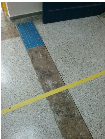
piso tátil faltante
