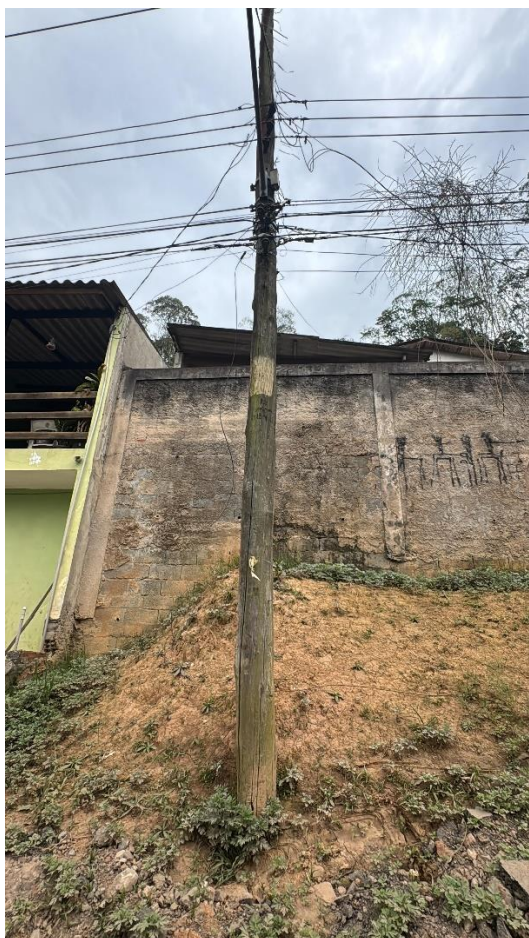
R. Jagatirica, 254 - Recreio da Borda do Campo (Poste com base rachada)
