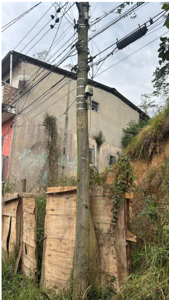
R. Jaguatirica, 301 - Recreio da Borda do Campo (Poste com base rachada)
