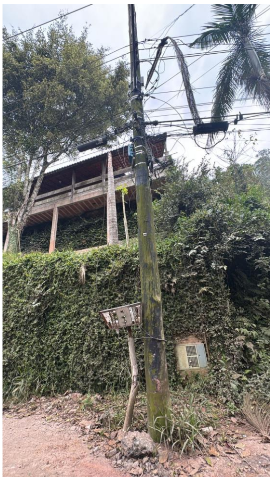
R. Jaguatirica, 600 - Recreio da Borda do Campo (Poste com base rachada)
