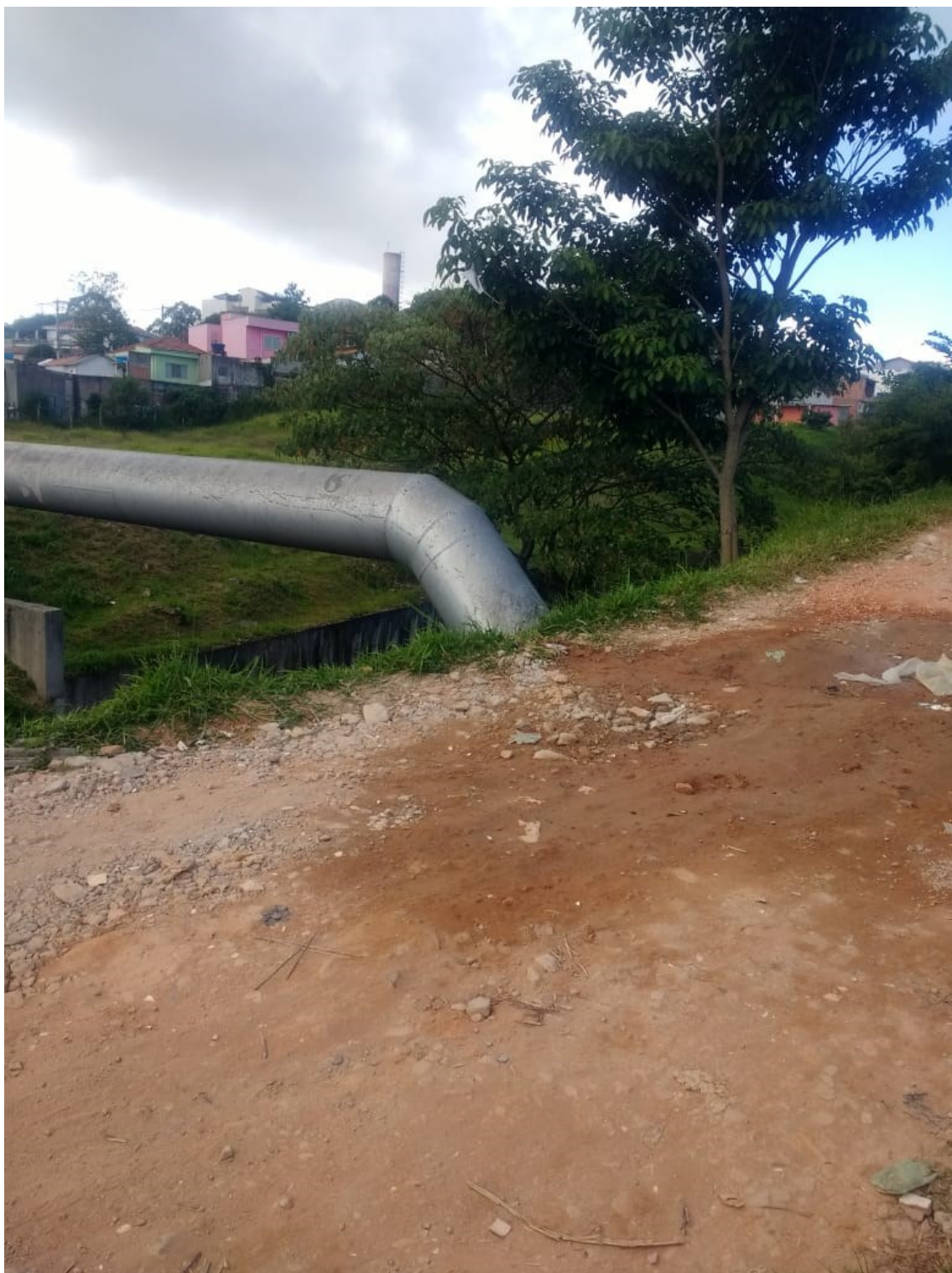
Vazamento av. Brasília
