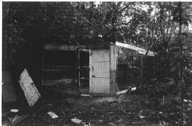
Construção irregular em área invadida
